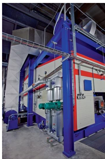
Obrázek 22 kotelna – topiště kotle v Borohrádku (zdroj: Alpine-energie)
