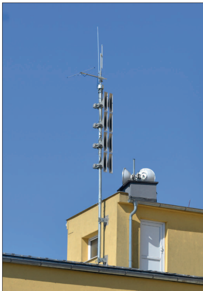
Nové sirény nainštalované na pekárni Gros.
