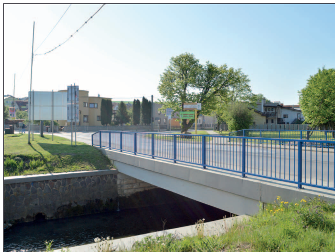
Na stretnutí sa hovorilo i o nutnej rekonštrukcii mosta pri pekárni.
