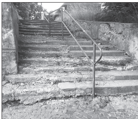
Schody budú podľa vyjadrenia ŽSR do konca roka opravené.
