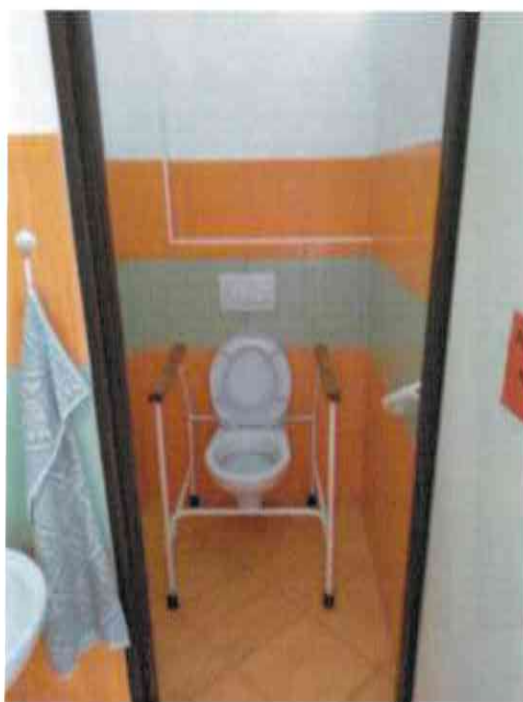
Pôvodné WC – nie bezbariérové
