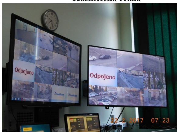
Obr.č. 12 – monitorovací systém na MsP
