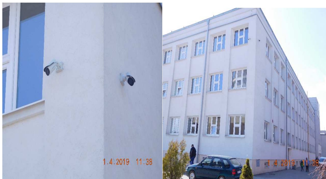
Nové kamery – budova NsP
