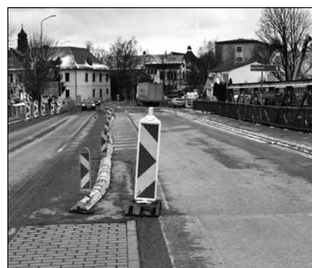
Nádejná rekonštrukcia je opäť v nedohľadne.
