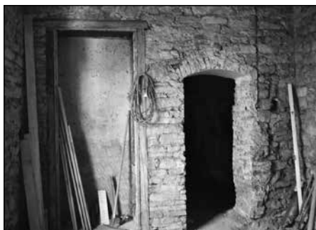
V súčasnosti sa objekt nachádza v nevyhovujúcom stave.
