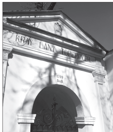
Hrob kežmarských martýrov si tiež už vyžaduje rekonštrukciu.
