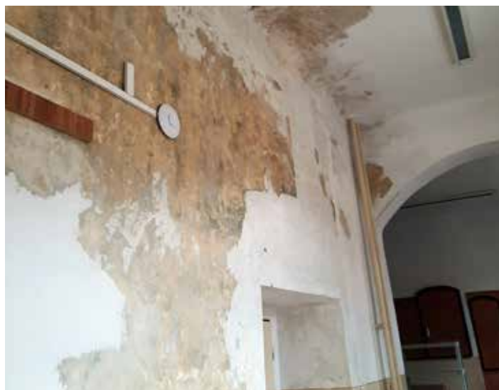
Steny v škole na Hradnom námestí dostali kvôli nehode s potrubím poriadne zabráť.
