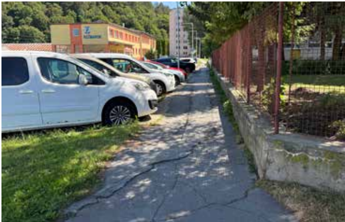
Aj chodník popri škole Nižná brána musí prejsť zásadnou opravou.
