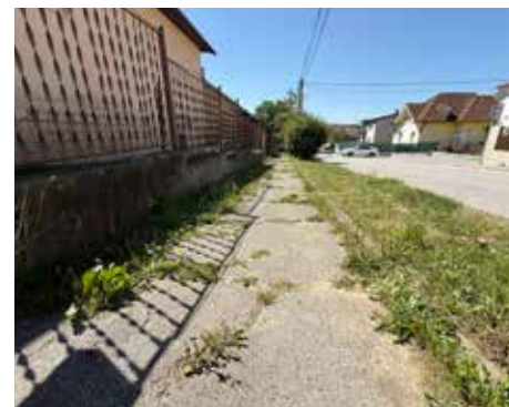
Deformovaný povrch chodníka nahradí nová zamková dlažba .
