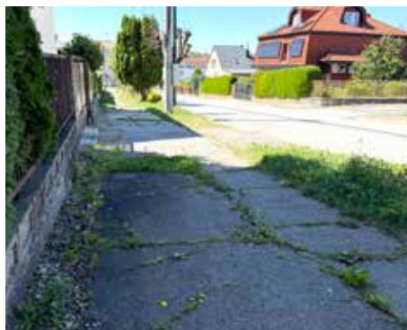
Staré povrchy z liateho asfaltu, značne poškodené budú vymenené na ulici Komenského.
